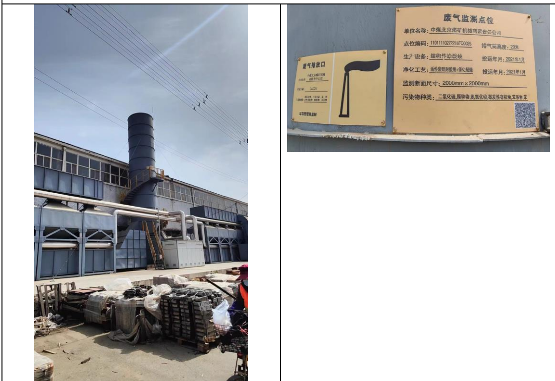
结构件喷漆废气排气筒及标识牌照片
