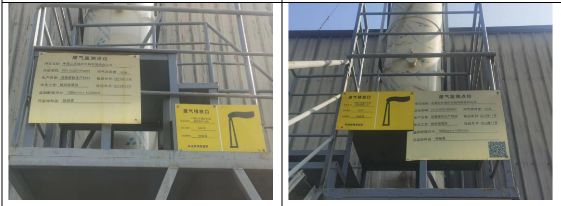
纽堡镀铬生产线排气筒及标识牌照片
