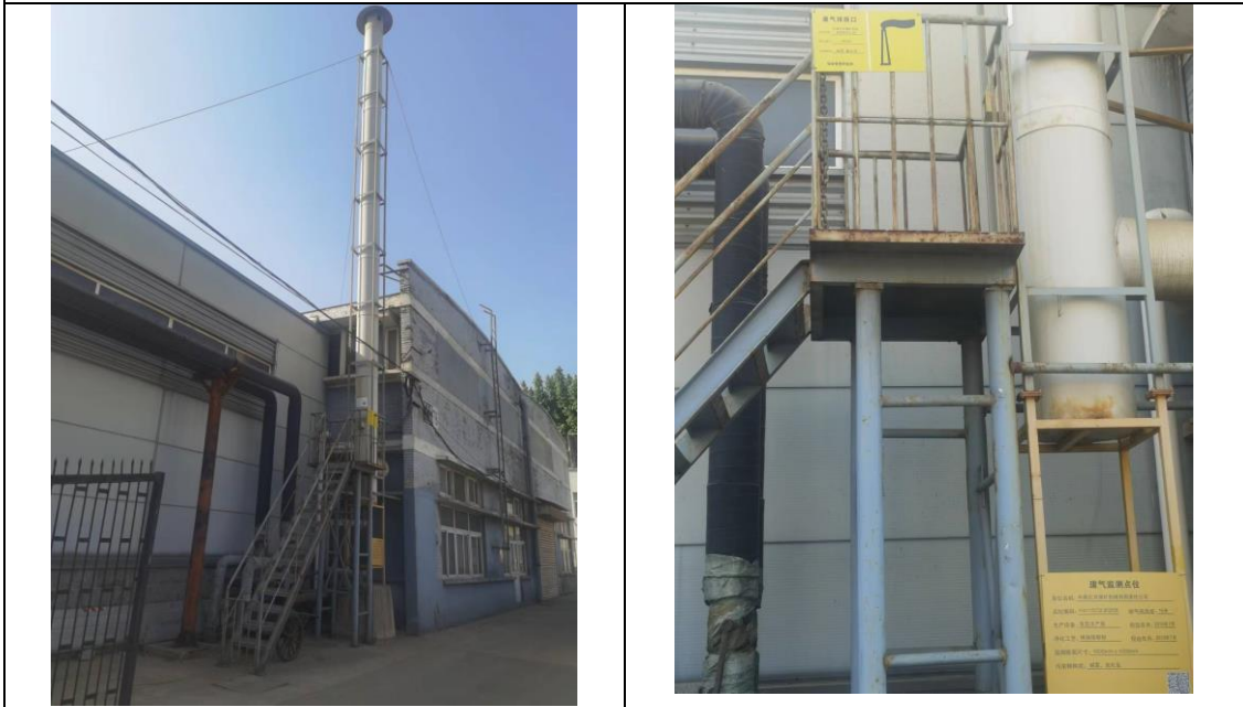
法兰线废气排口及标识牌照片
