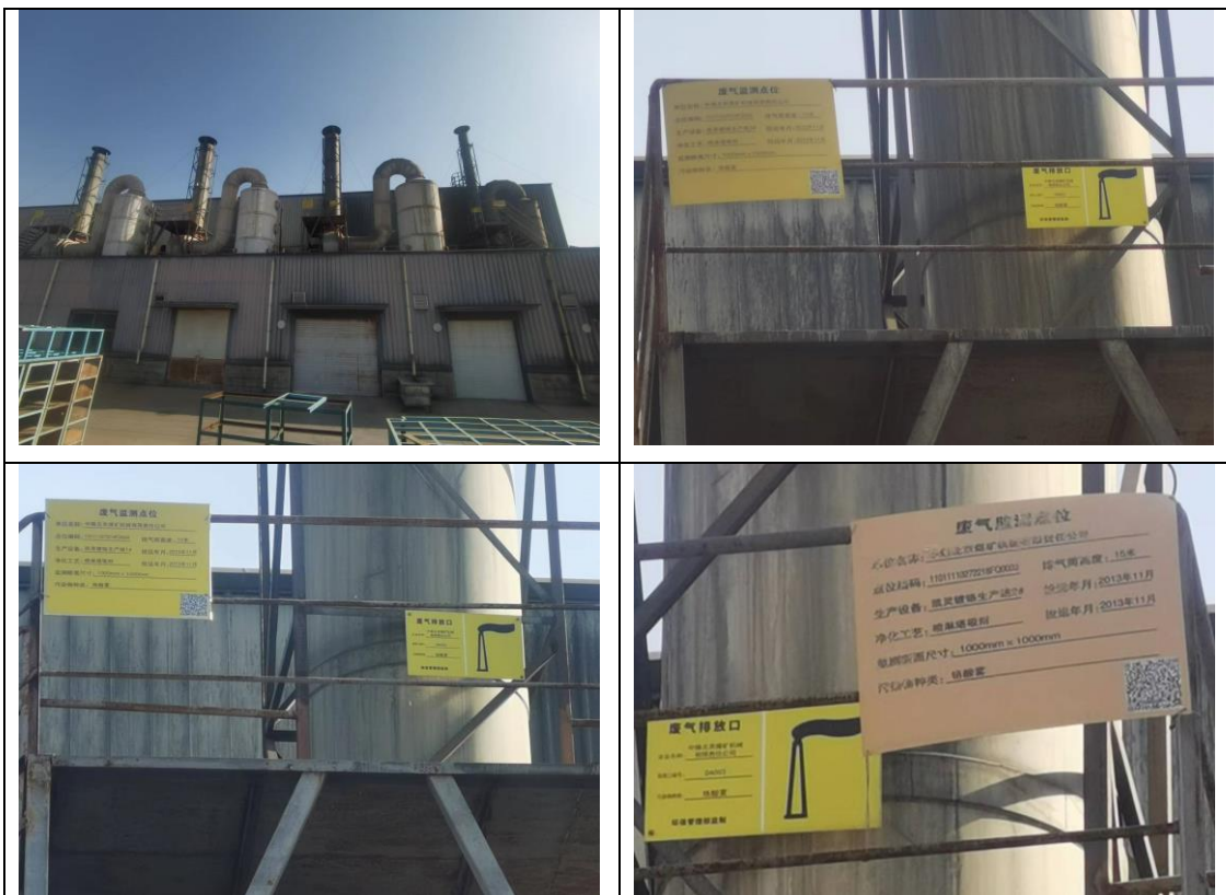
凯灵镀铬生产线排气筒及标识牌照片
