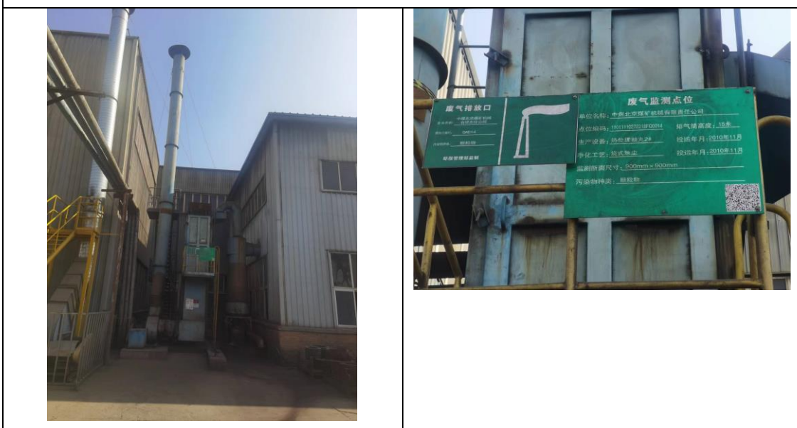
热处理抛丸 2#废气排口及标识牌照片
