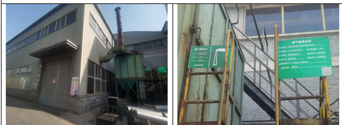
热处理抛丸 1#废气排口及标识牌照片
