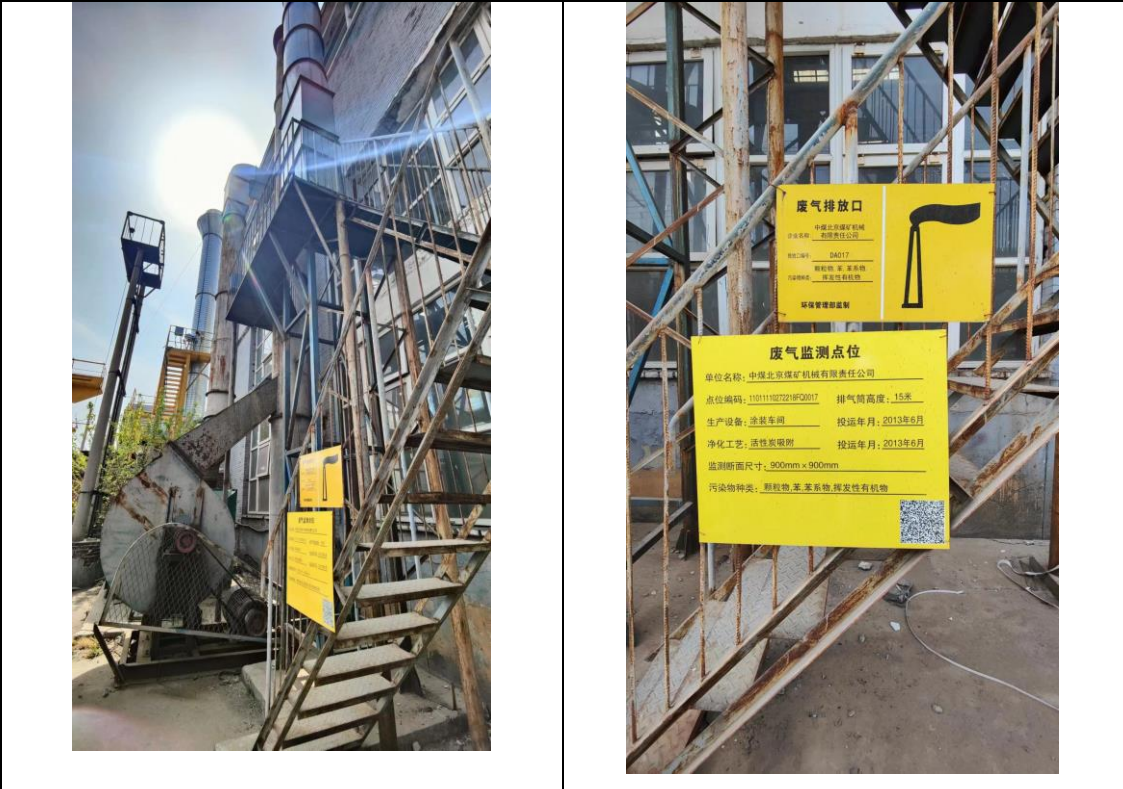
原油缸移动喷漆房喷漆废气排气筒及标识牌照片
