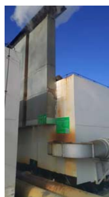
楼顶废气排口
