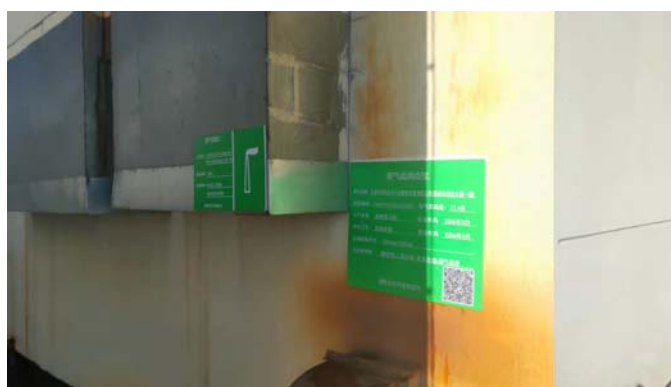
图 5 现状废气排口规范化管理照片
